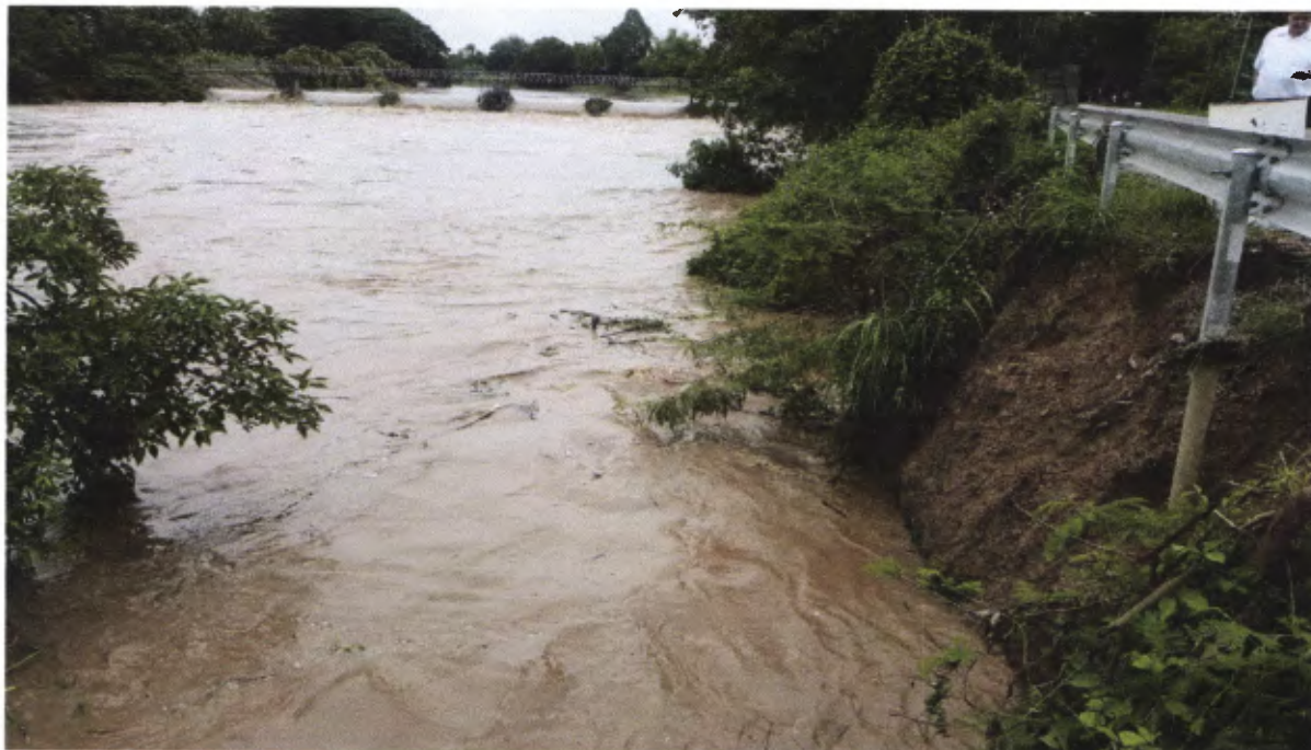
ภาพความเสียหายถนนชลประทานสายสบปะ เลียบลำน้ำปิง บริเวณพื้นที่ตำบลริมปิง ณ วันที่ 3 ตุลาคม 2561
