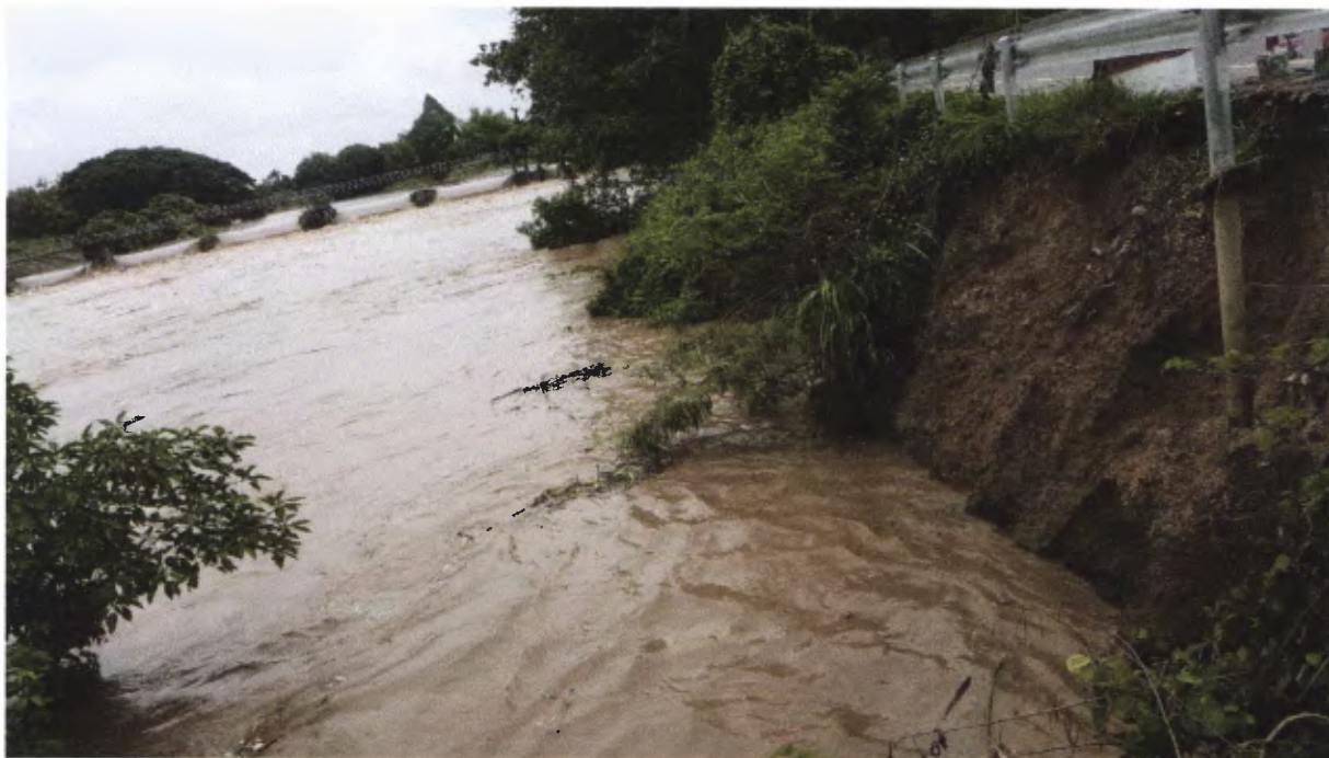
ภาพความเสียหายถนนชลประทานสายสบปะ เลียบลำน้ำปิง บริเวณพื้นที่ตำบลริมปิง ณ วันที่ 3 ตุลาคม 2561
